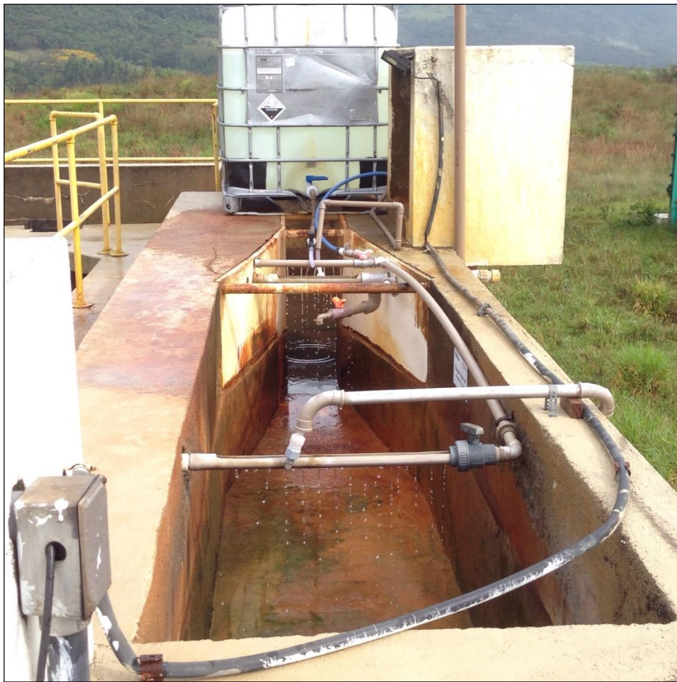
Figura 73: Detalhe da Calha Parshal que tem por finalidade o controle da vazão de entrada. Recebe a aplicação dos produtos químicos promovendo a mistura rápida. É responsável pela correção das características do afluente.
