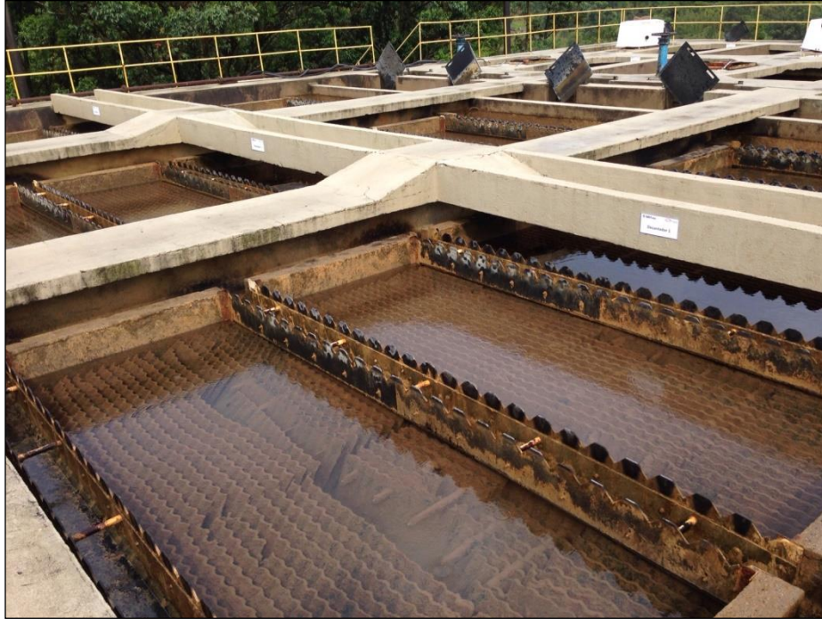
Figura 75: Utilização de decantador com lâminas quebradas.
