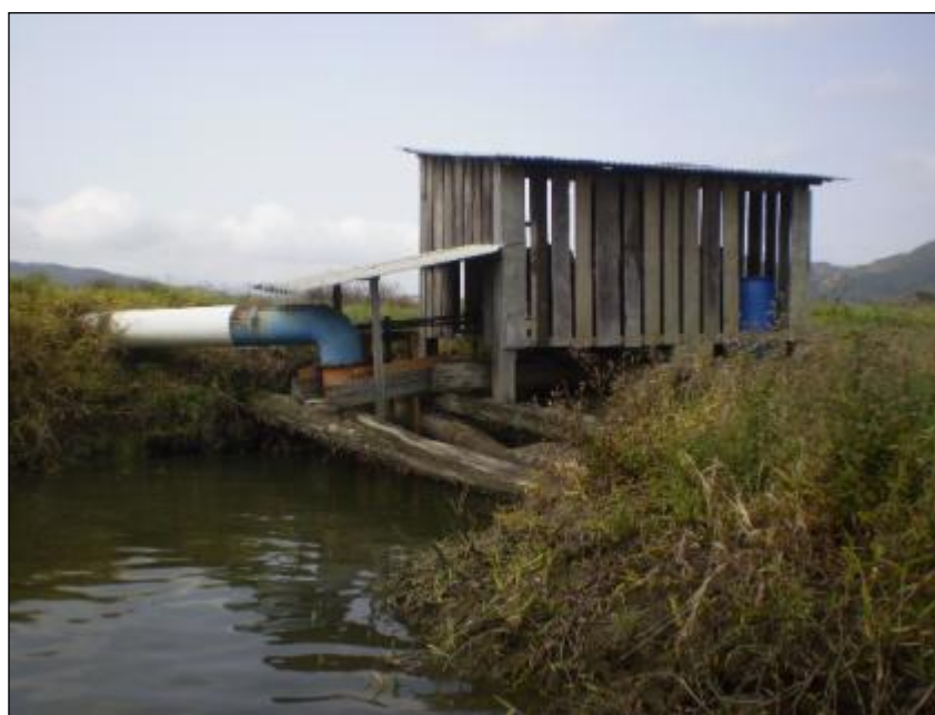
Figura 55: Captação de Água da Rizicultura (Montante da Captação).
