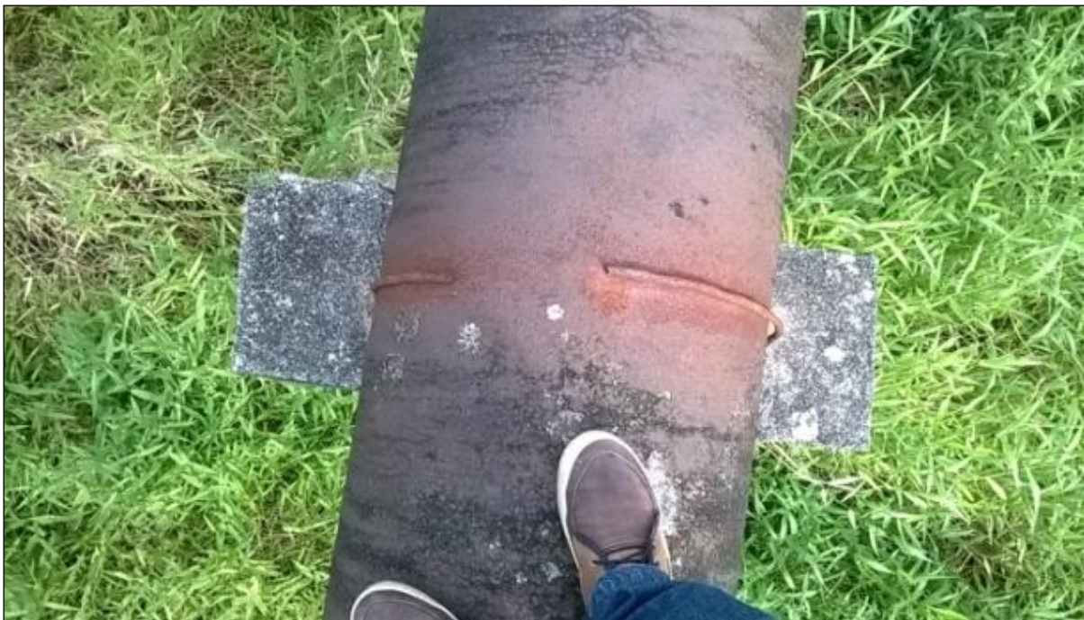
Figura 66: Detalhe da ancoragem rompida.
