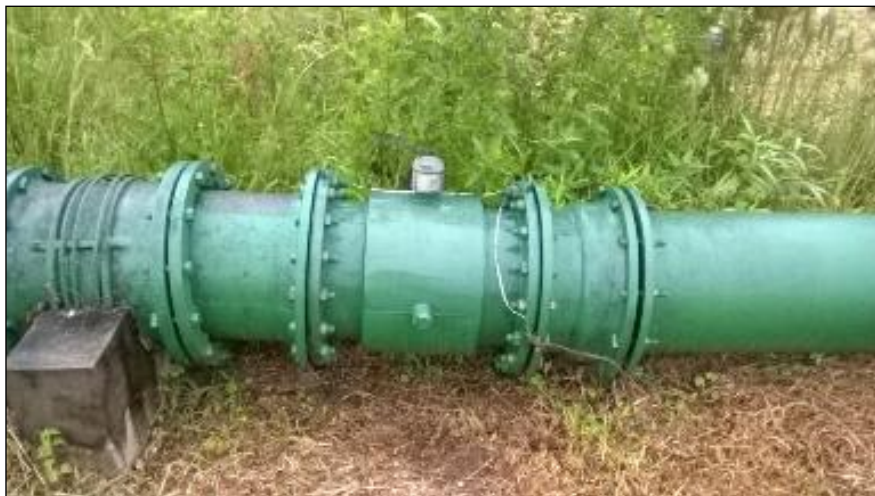
Figura 82: Macromedidor saída ETA.
