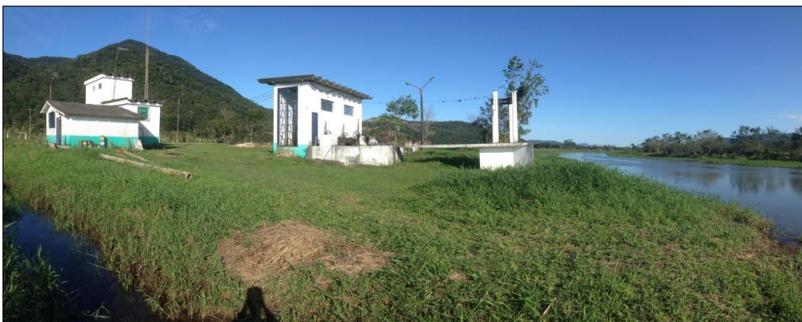
Figura 34: Estação de Captação de água Rio D'Una.
