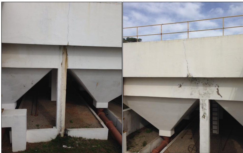
Figura 76: Utilização de decantador com rachaduras e infiltrações.
