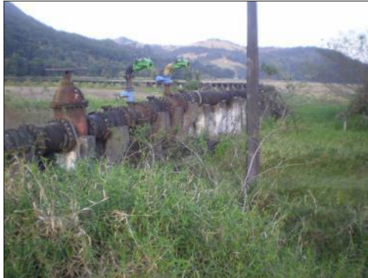
Figura 65: Adutora de Água Bruta do Rio D'Una.
