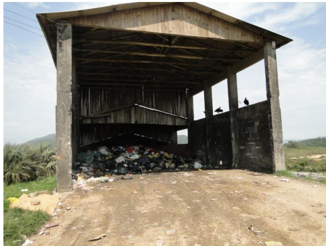
Figura 122: Resíduos triados armazenados em pátio aberto.
