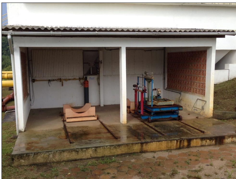
Figura 78: Vista e detalhes das instalações de Cloro gasoso.
