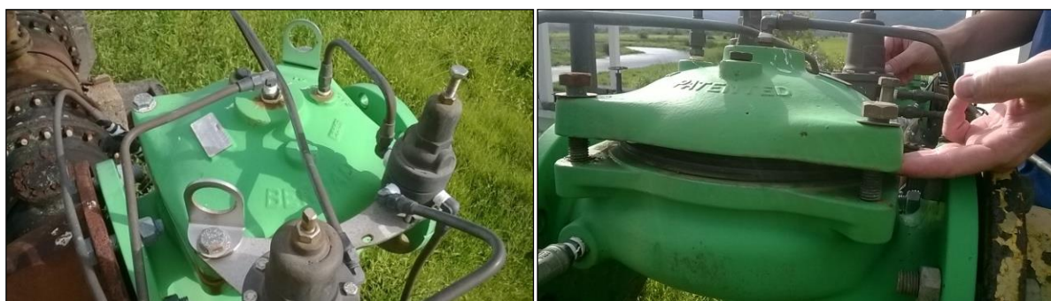
Figura 67: Detalhe das válvulas de alívio.
