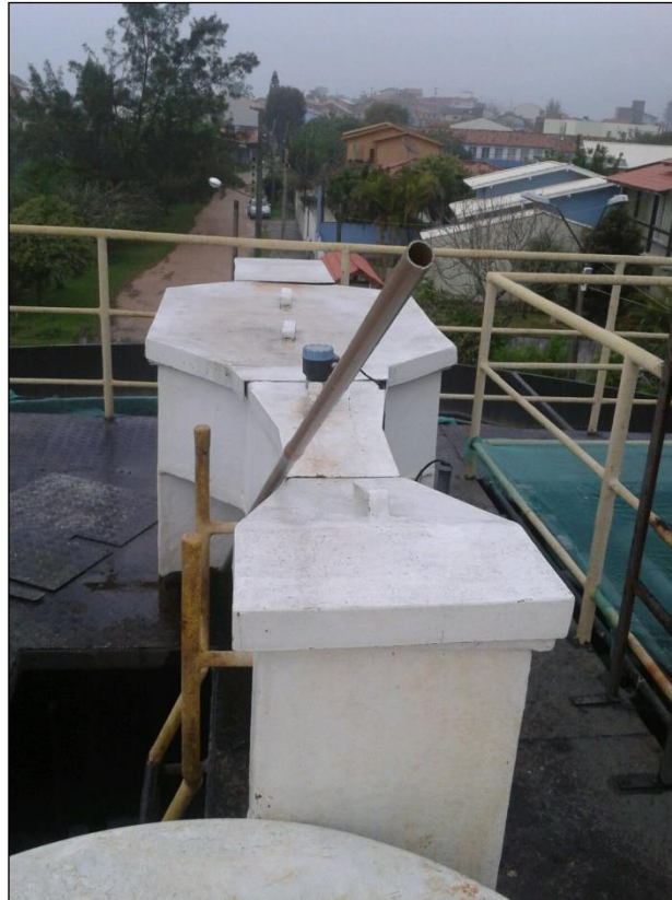
Figura 111: Calha Parshall com caixa de distribuição do efluente para dois pontos do UASB
