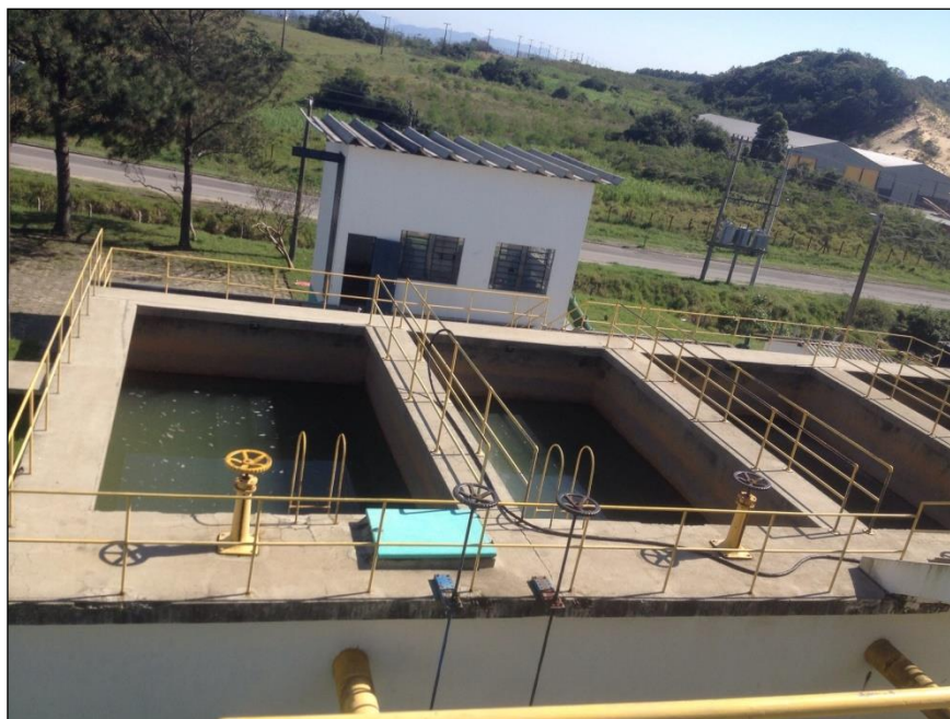
Figura 70: Vista da ETA( ERAT e filtros).
