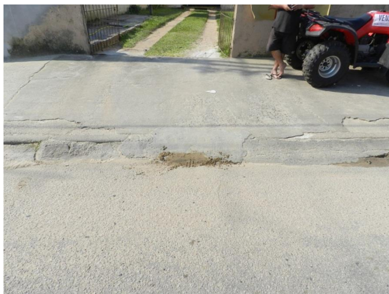
Figura 166: Caixa coletora na Rua Itamar Luiz da Costa.
