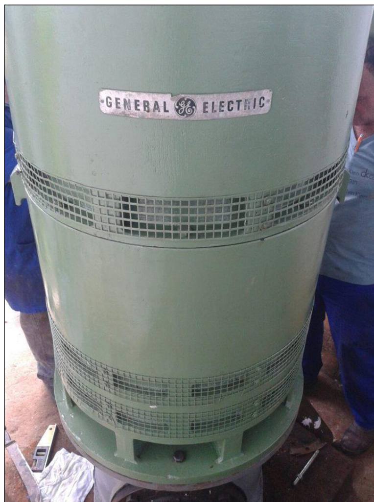
Figura 41: Motobomba da EEAB Rio D'Uma.
