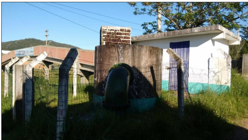
Figura 86: Caixa de Quebra de Pressão (Vila Nova Alvorada).
