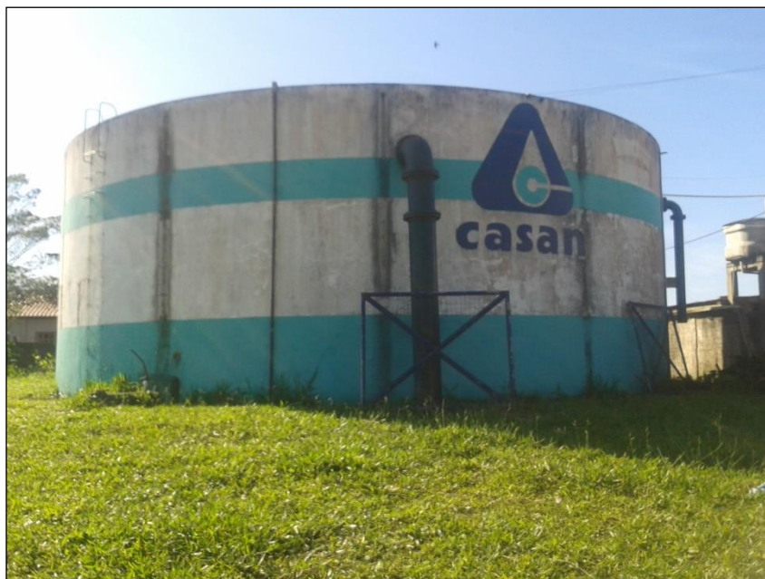
Figura 92: R4 e tubulação de Aproveitamento de Água de Chuva (Nov de 2010).
