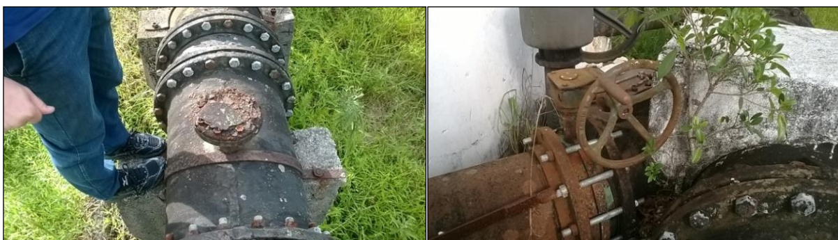
Figura 43: Detalhe de corrosão nas conexões e problema de ancoragem da EEAB Rio D'Una
