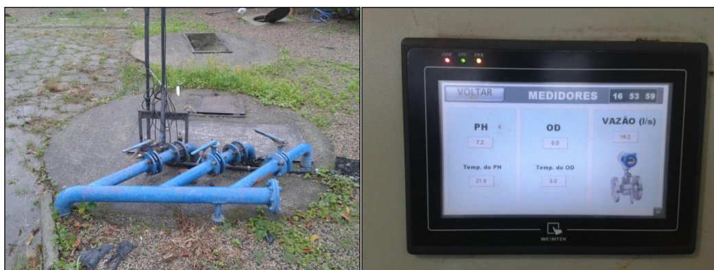
Figura 112: Medidores de nível e tela do CLP de controle de acionamento.
