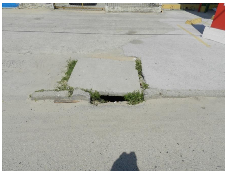
Figura 170: Caixa coletora na Rua Benito Ruiz.
