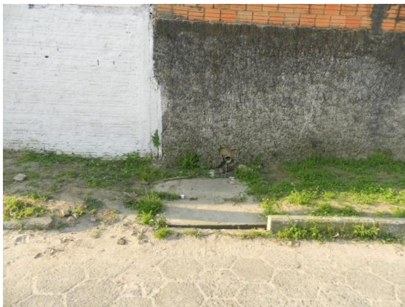
Figura 154: Caixa coletora sem abertura para entrada de água
