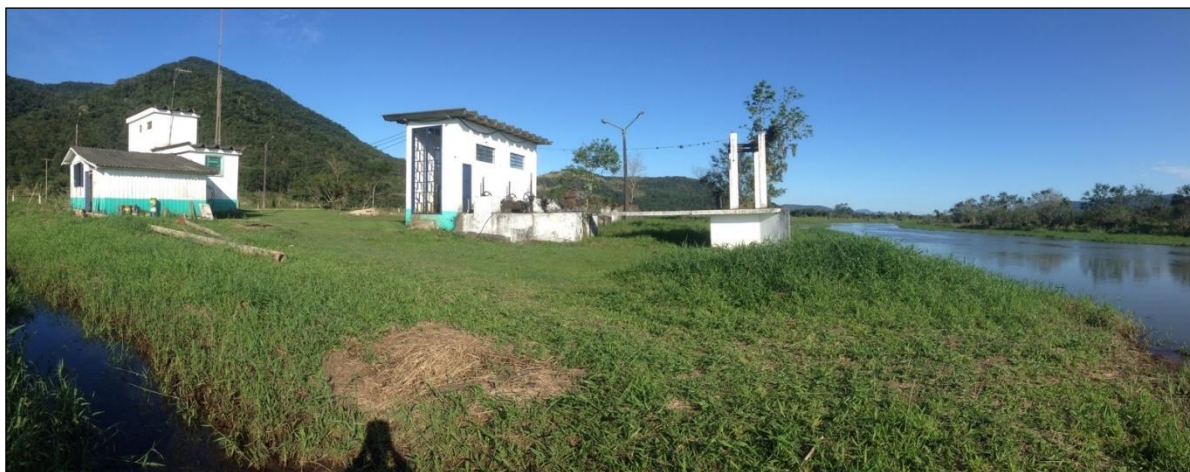
Figura 64: Estrutura Física na Captação no Rio D'Una.
