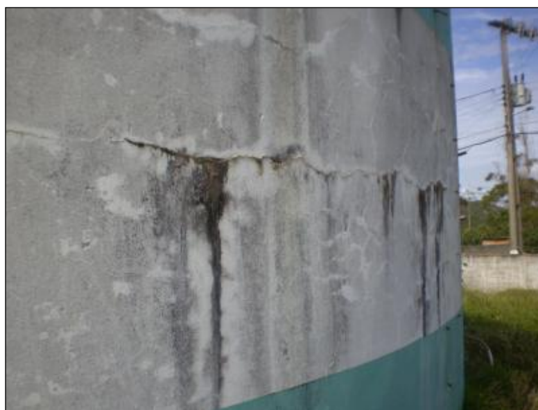
Figura 93: Fissuras R4 (Nov 2010).
