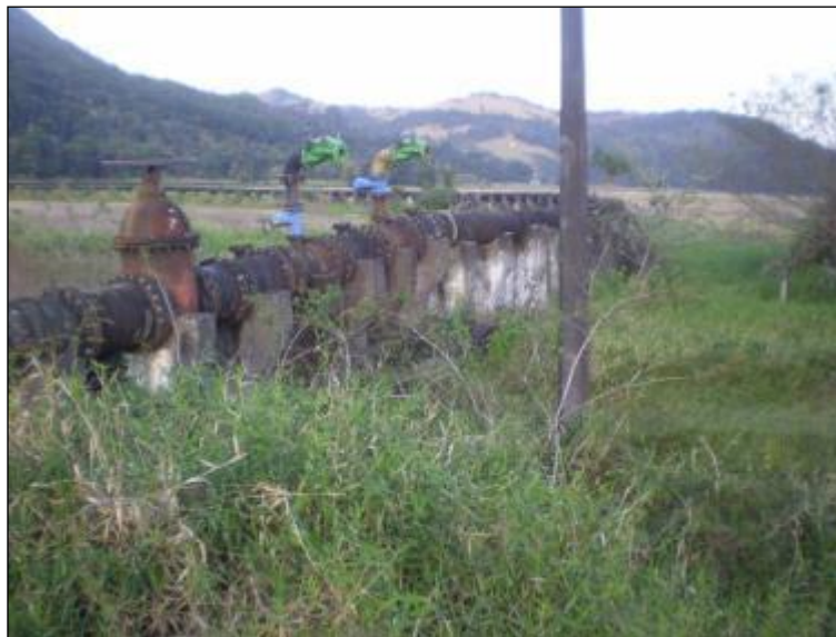
Figura 65: Adutora de Água Bruta do Rio D'Una.
