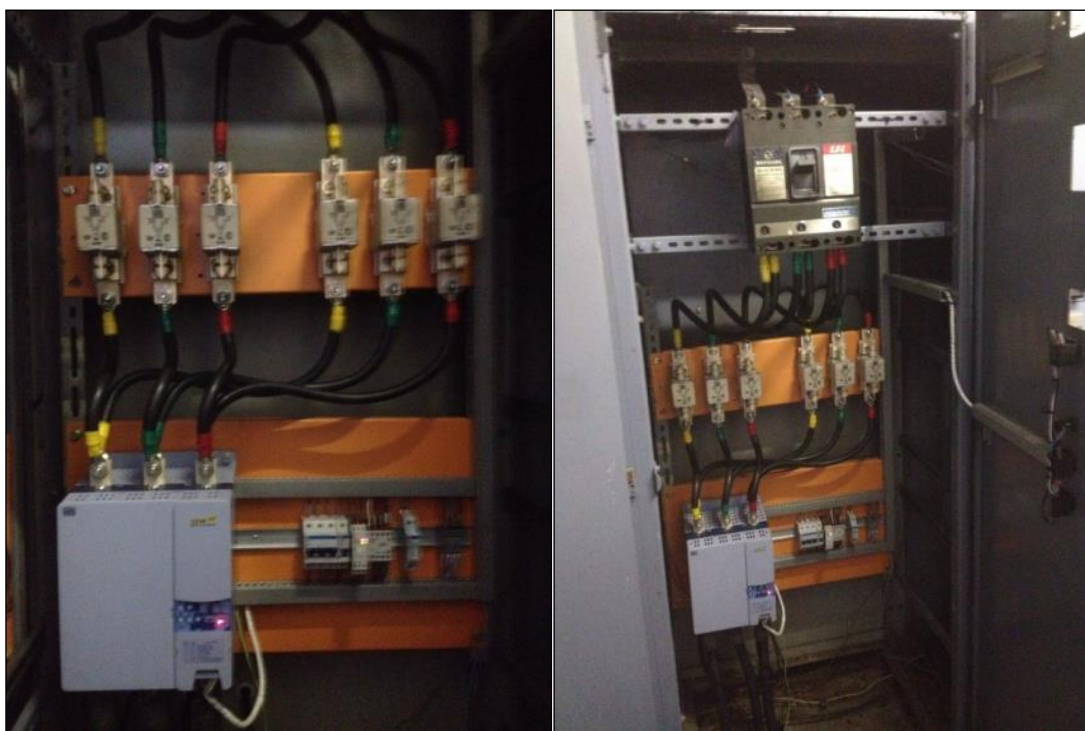
Figura 42: Vista dos Painéis de Comando Reformados da EEAB Rio D'Una.
