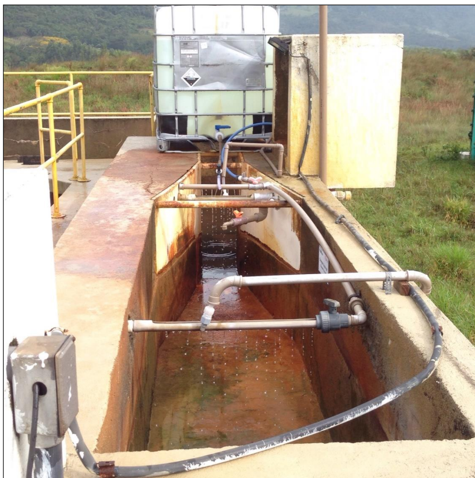
Figura 73: Detalhe da Calha Parshal que tem por finalidade o controle da vazão de entrada. Recebe a aplicação dos produtos químicos promovendo a mistura rápida. É responsável pela correção das características do afluente.
