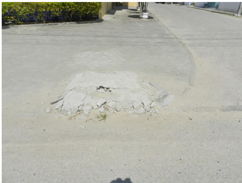
Figura 156: Rua sem sarjeta e com uma caixa coletora completamente fechada
