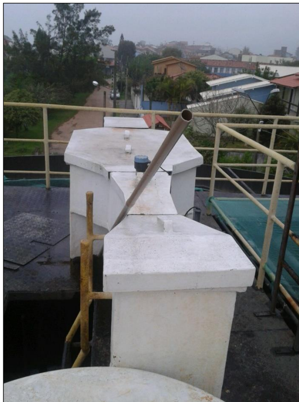
Figura 111: Calha Parshall com caixa de distribuição do efluente para dois pontos do UASB
