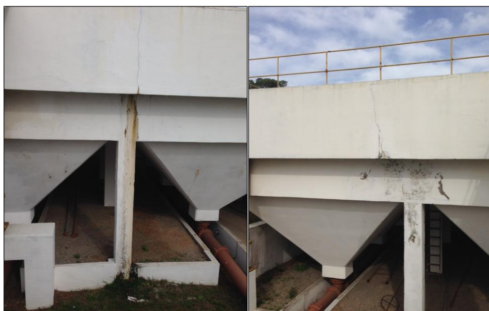
Figura 76: Utilização de decantador com rachaduras e infiltrações.
