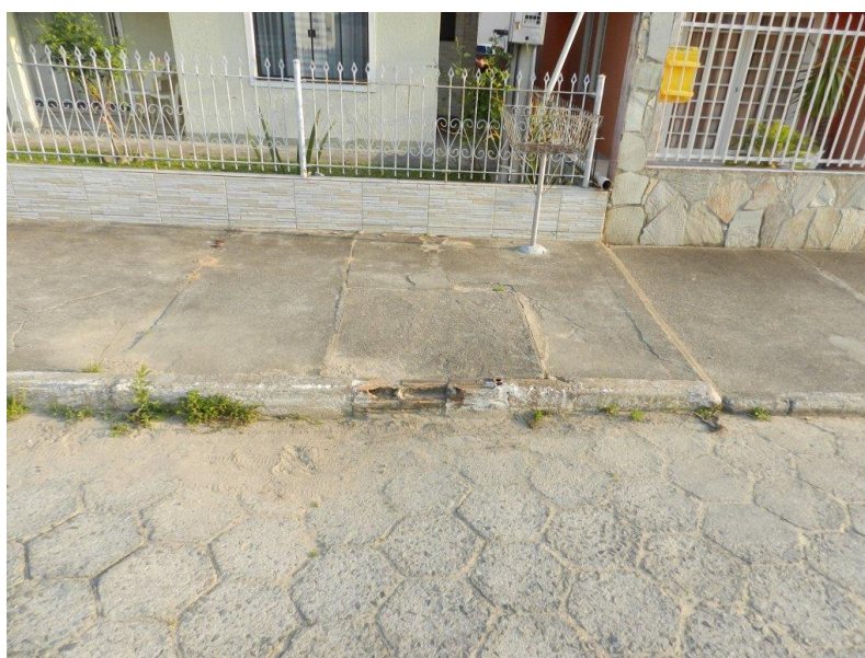
Figura 164: Caixa coletora na Rua São José.
