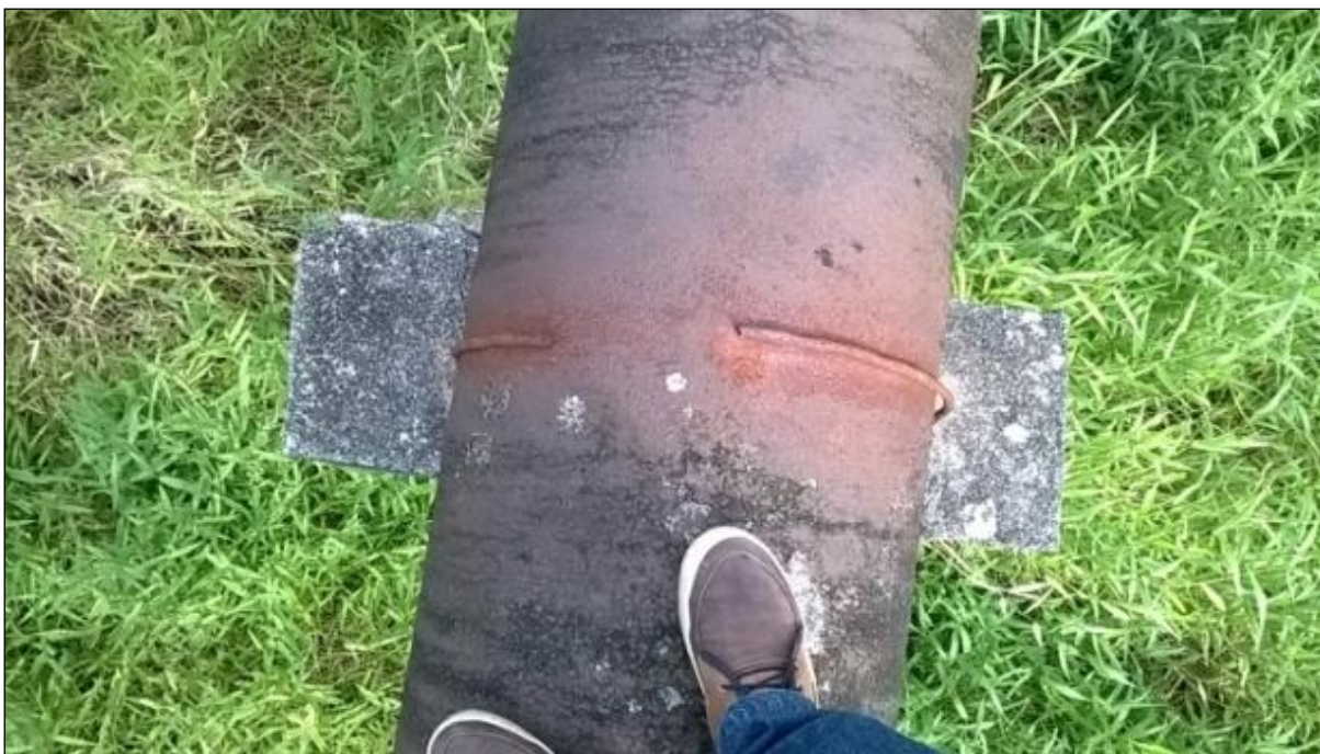
Figura 66: Detalhe da ancoragem rompida.
